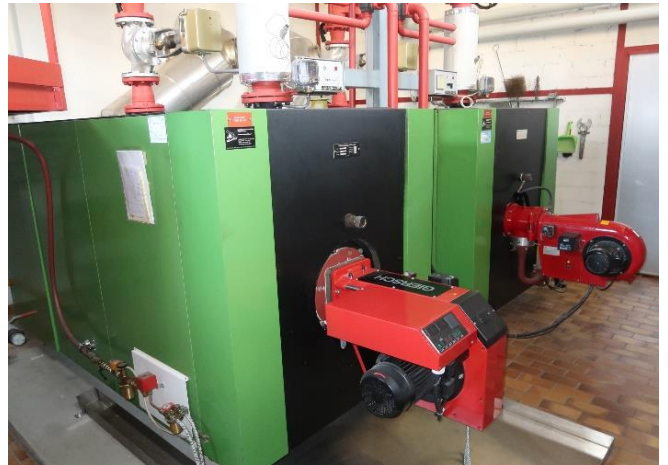
Heizanlage für die Häuser 1 - 5
