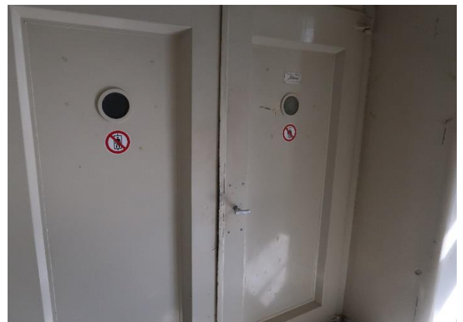
Liftnlage nur noch Güter (Personen abgesprochen)
